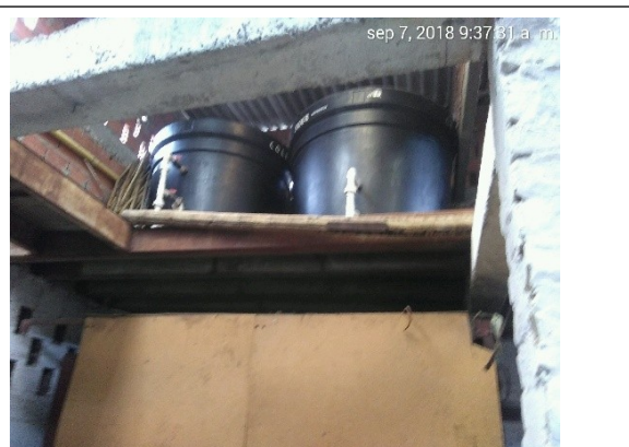
Foto No. 6 Sistema de tratamiento de ARnD.
